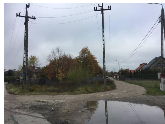
Fotografia 8 - Widok na fragment napowietrznej linii średniego napięcia.
